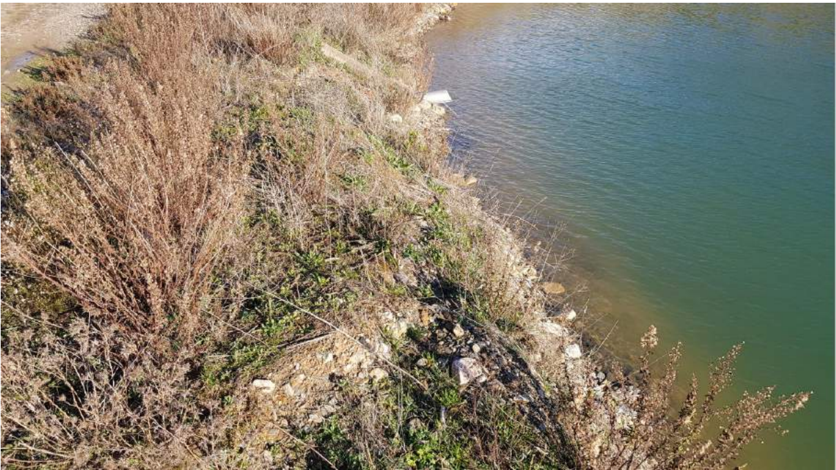
Point d'observation 8 : 4 zones d'érosion décimétriques sur la digue entre les bassins 3 et 4 observées en 2018 n'ont pas évoluées en 2021
