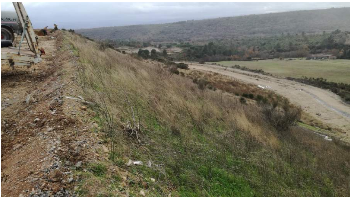
Points d'observation 5 et 6 : Ancienne zone instable sans évolution notable depuis son traitement en 2007
