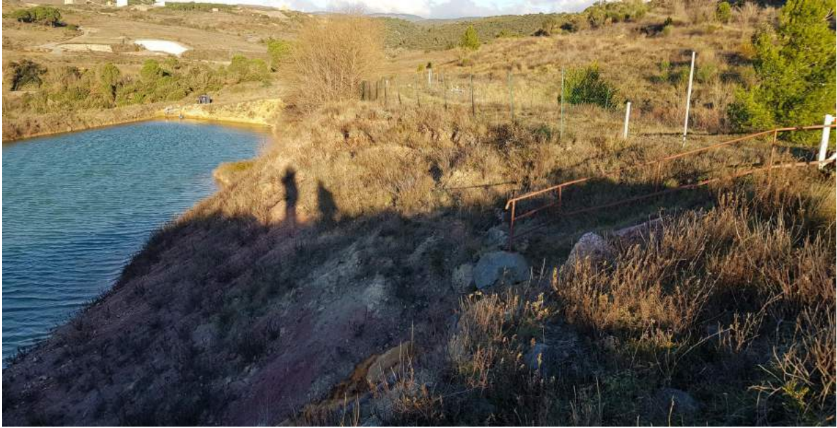
Point d'observation 19 : Instabilité sur talus Est du bassin1 (2021) – peu d'évolution
