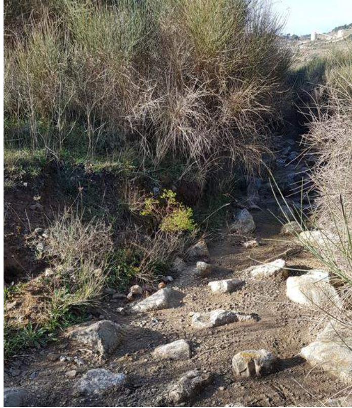
Point d'observation 33 : Mise à nu des résidus miniers devant enrochement (partie haute de la rampe)
