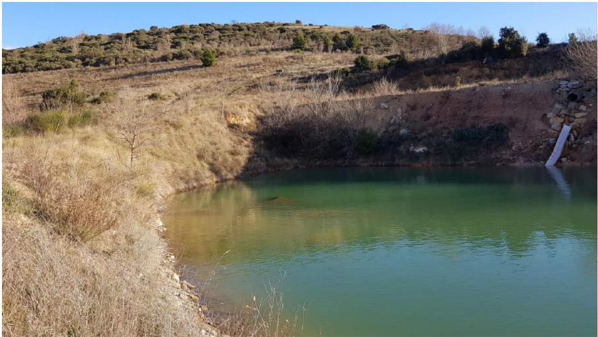
Point d'observation 8a : petite zone de glissement superficielle dans l'angle du bassin 3 – Pas d'évolution en 2021
