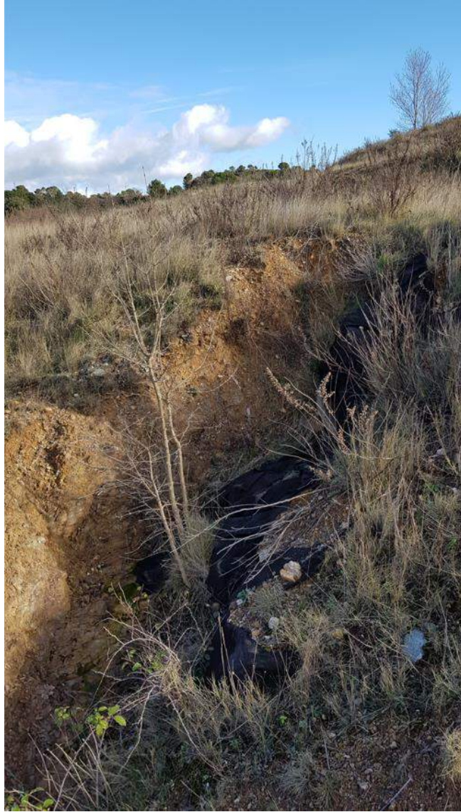
Point d'observation 12: zone d'évacuation de la buse de sortie du bassin (forte érosion)
