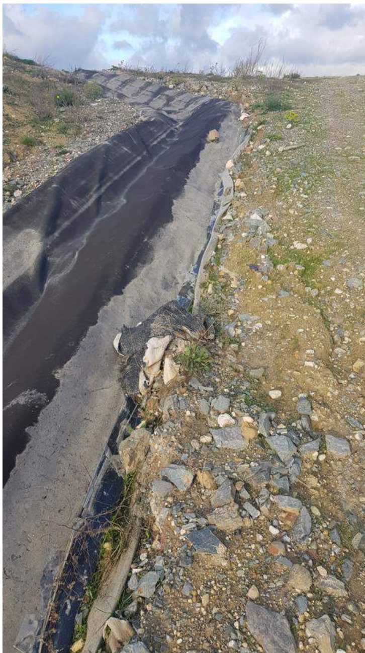
Point d'observation 4 (2022) : traces d'érosion à proximité du fossé
