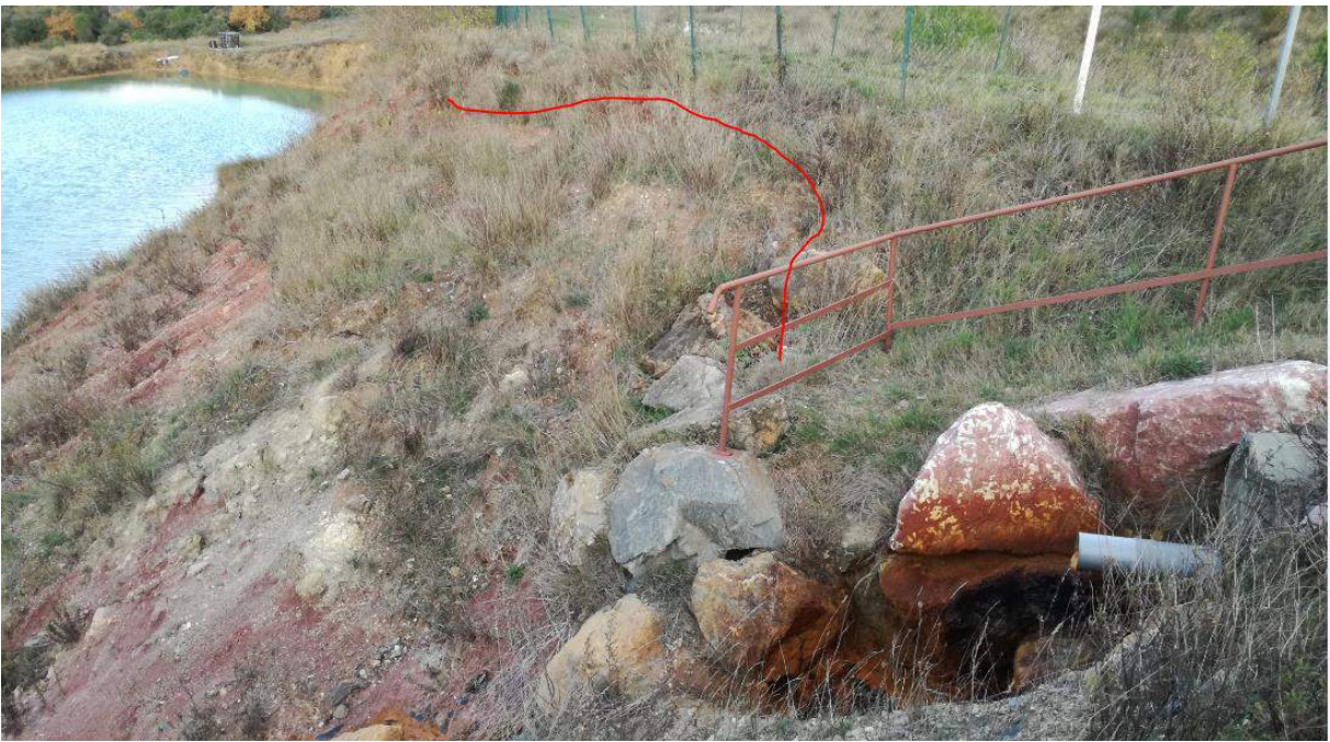
Point d'observation 19 : Instabilité sur talus Est du bassin1 (2020)
